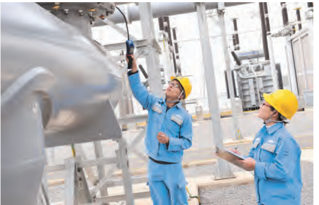
为了让广大群众过上一个欢乐祥和的节日,春节期间,大理电网员工放弃和亲人团聚的欢乐,坚守岗位,认真履职尽责,让各族群众度过一个亮堂堂的春节。图为节日期间大理500千伏变电站员工认真巡视设备。李灿斌 摄
