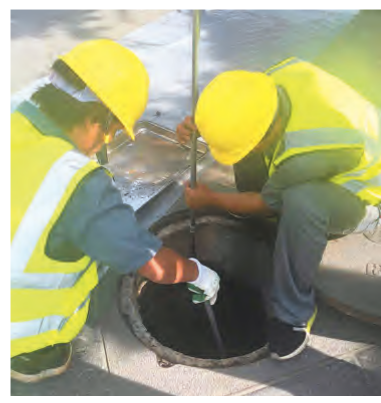
为有力实施洱海保护治理“七大行动”,结合大理古城核心区污水管网和市政基础设施建设要求,从今年6月起,市古保局在大理古城范围内开展排水、排污管网集中清淤疏浚及“毛细血管”支管网建设工作。通过对大理古城的污水进行有效收集和处理,切实提升古城人居环境,保障城市市政设施高效运行。 本报通讯员 摄
